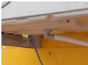
Odvod kondenzata s vanjske jedinice
