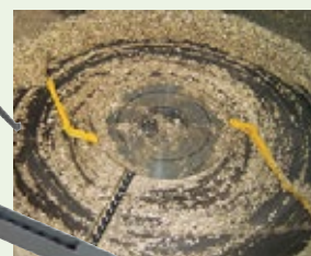
TAS 4 sistem za uduzimanje drvene mase iz visokih silosa
