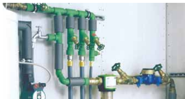
Kućna priključna stanica
